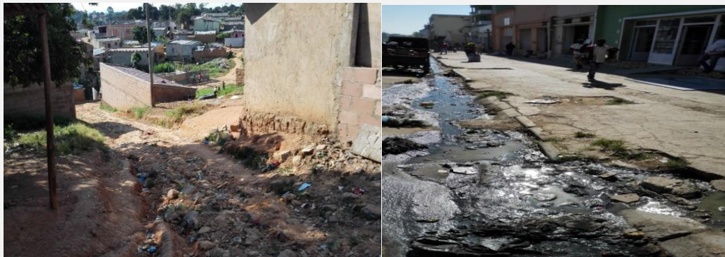
Fig.1: O Crescimento urbano, a força da correnteza das águas pluviais e a falta de drenagem ajudam as águas pluviais, domésticas ou industriais a ravinar a estrada de há um ano.
